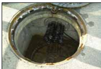
情報ボックスマンホール内部
