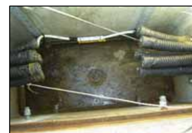
中継マンホール内部
